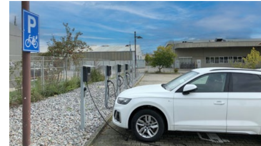
Ladeinfrastruktur Paragon Standort Schwandorf
